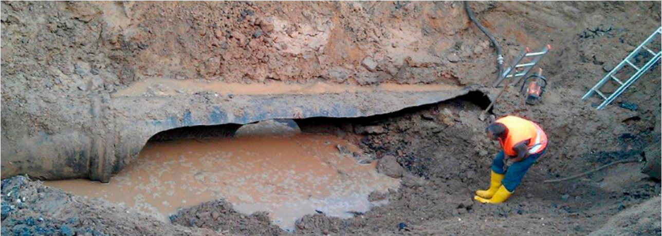
Rohrbruch, Wassertransportleitung DN 800
