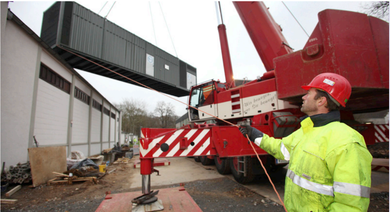
Einrichtung einer Notstromversorgung für ein Wasserwerk
