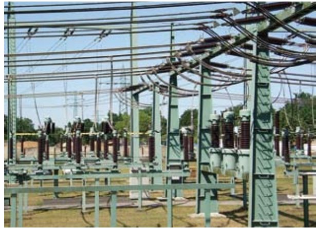
Kritische Infrastruktur: Umspannwerke – notwendige Schnittstellen in der Stromversorgung
