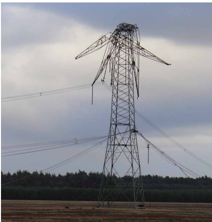
Sturmschaden durch den Orkan Kyrill im Jahr 2007
