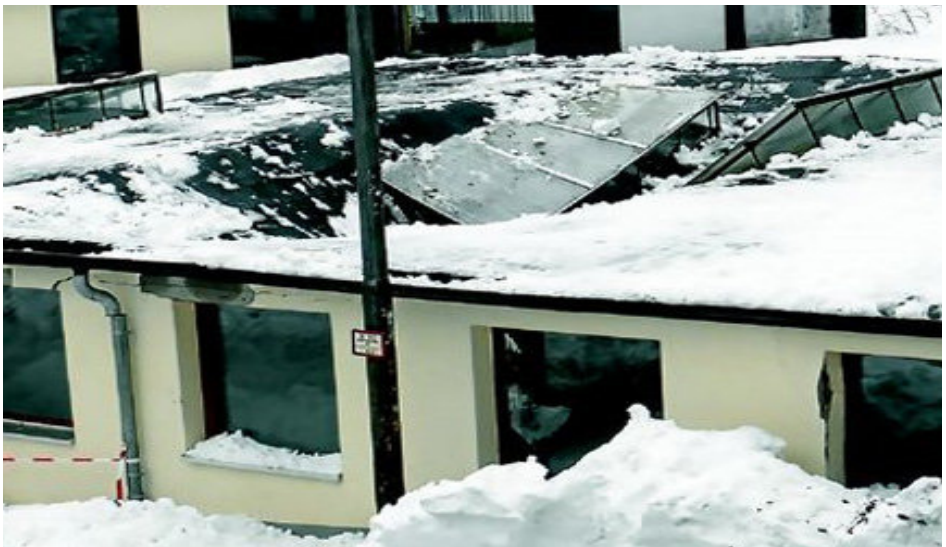
Flachdächer und weitgespannte Dächer sind bei Schneelast besonders einsturzgefährdet.
