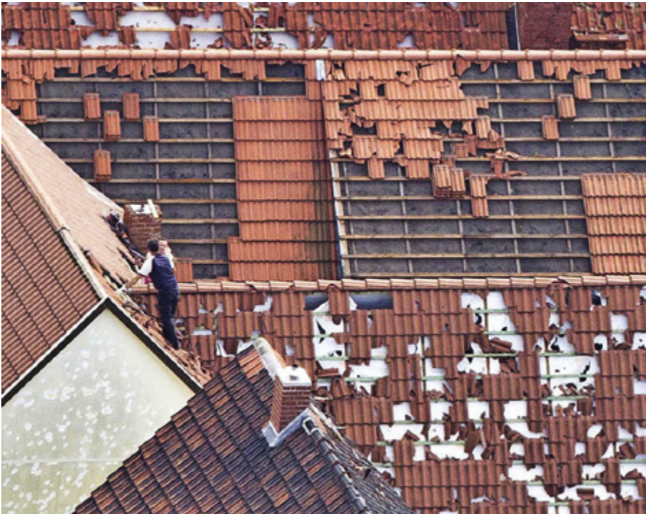
Bei Hagel können Dachziegel und Dachfenster brechen.
