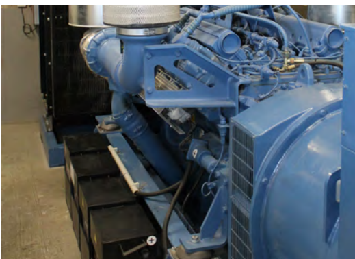
Abbildung 7 Netzersatzanlage (Quelle: BBK)
