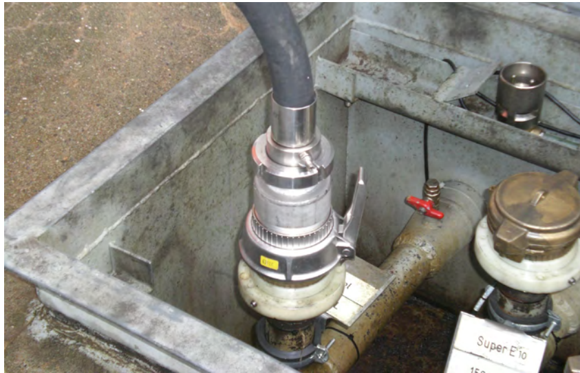
Abbildung 22 Anschluss Chemikalienschlauch (Quelle: M. Tessin).
